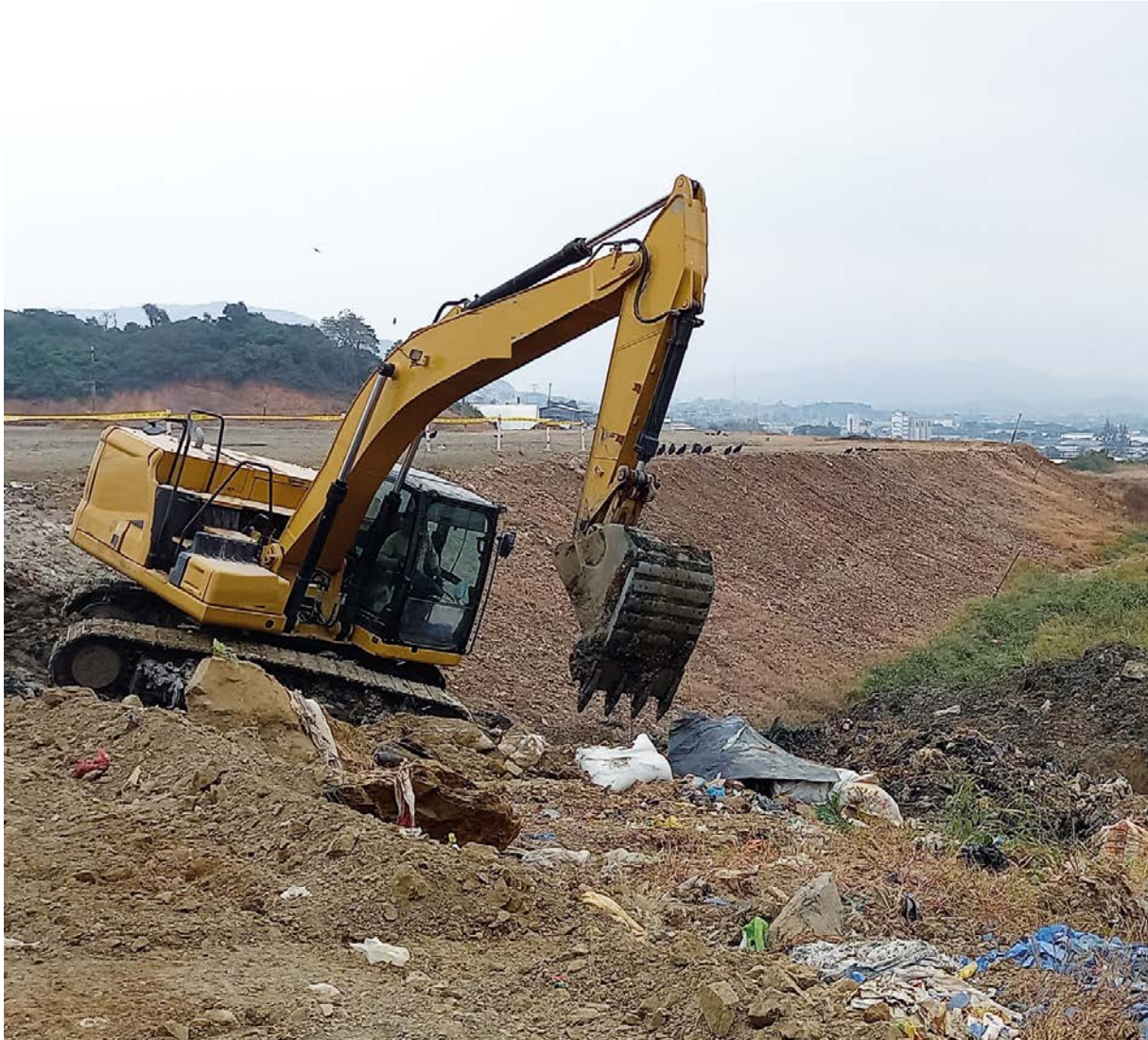
Imagen 11. Cobertura de la celda Fuente: STAND/UNODC
